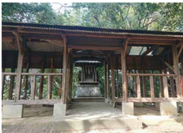
現在、拝殿は骨組みのみが残っている。奥には本殿があり、拝殿の右側には稲荷社がある。
